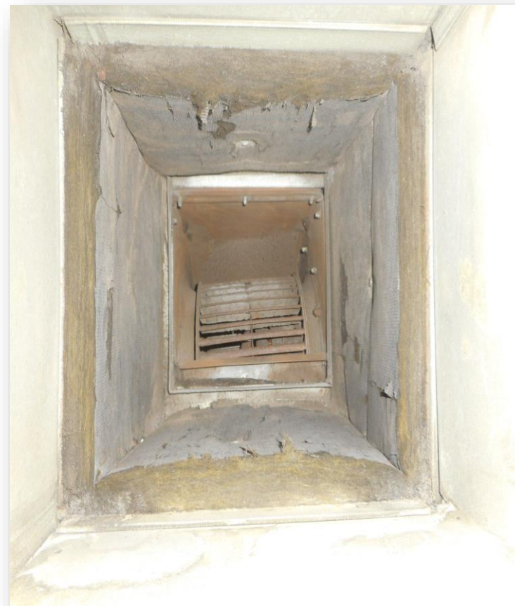
Fan Terminal Unit
