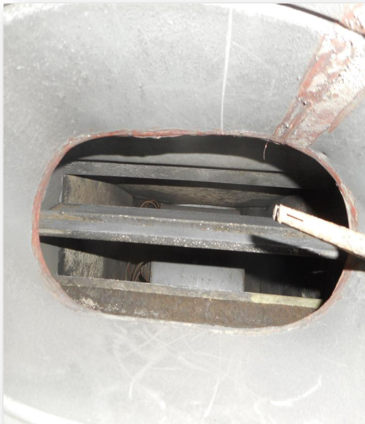
Fan Terminal Unit
